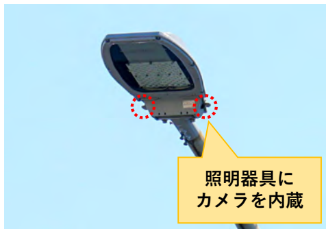
道路管理カメラ付き街路灯
