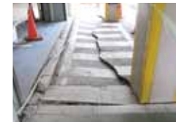
戸塚区役所の被害調査(H23.3.12)
