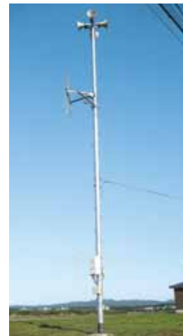
防災行政無線を利用した屋外スピーカー
